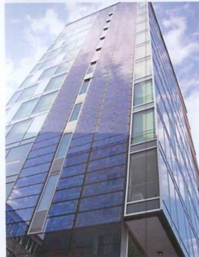
■ Slika 5. Kolektori ugrađeni u fasadu zgrade (www.hsuse.hr)
