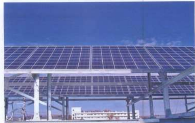
■ Slika 4. Kolektorski sustav za pripremu tople vode
